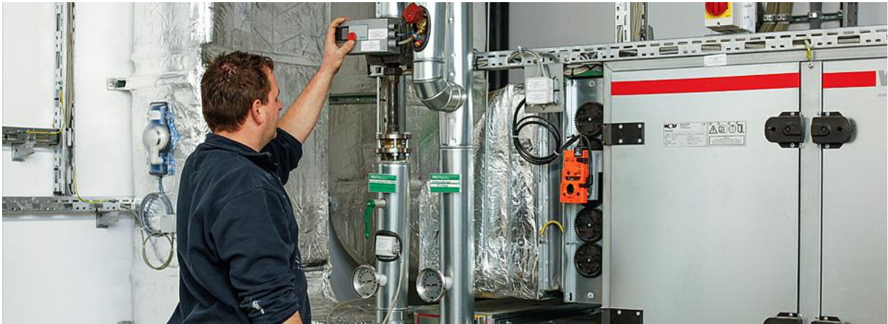
Technischer Hauswart: Visuelle Funktionskontrolle an einer Teilklimaanlage
